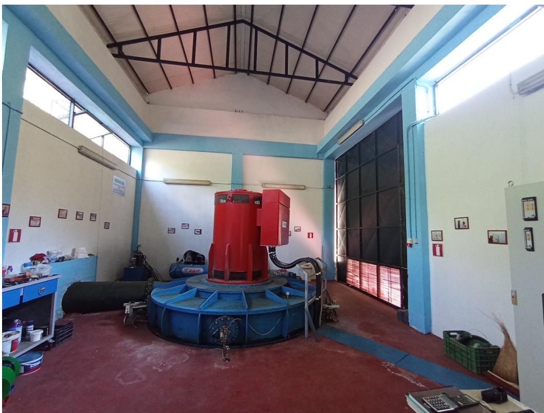
Εικόνα 3: Εσωτερικό κτιρίου με την στροβιλογεννήτρια
