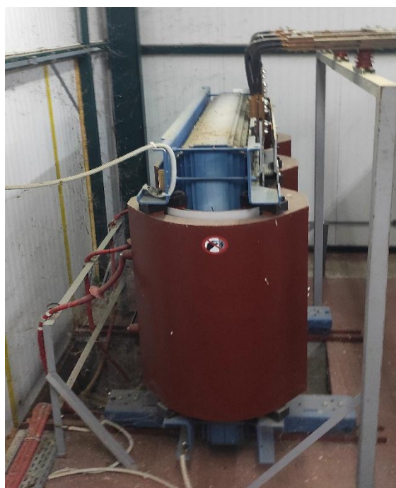
Εικόνα 4: Μετασχηματιστής Μέσης Τάσης. Στο έργο εγκαταστάθηκε ένας μετασχηματιστής ανύψωσης ο οποίος είναι αερόψυκτος, τριφασικός ξηρού τύπου.
