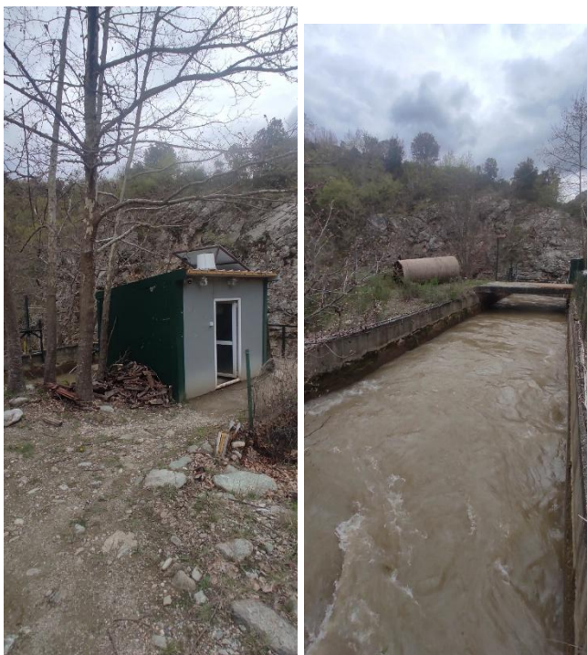
Εικόνα 7: Οικίσκος χειρισμού θυροφραγμάτων και Εξαμμωτής
