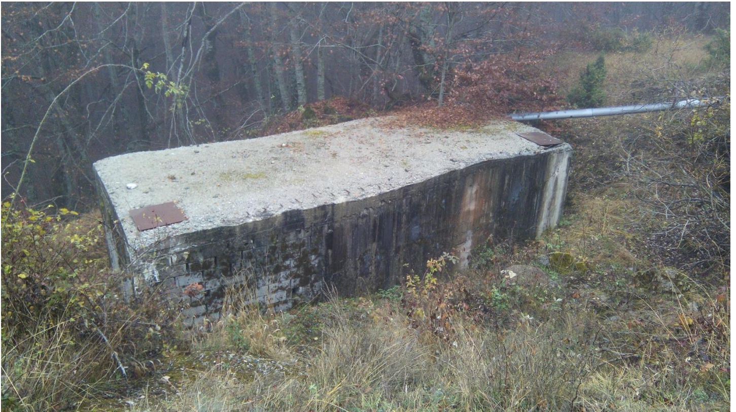
Φωτογραφία 1: Άποψη του συστήματος διθάλαμης στεγανής δεξαμενής και της απομονωμένης και εκτός λειτουργίας απορροφητικής δεξαμενής της Βάσης του X/K
