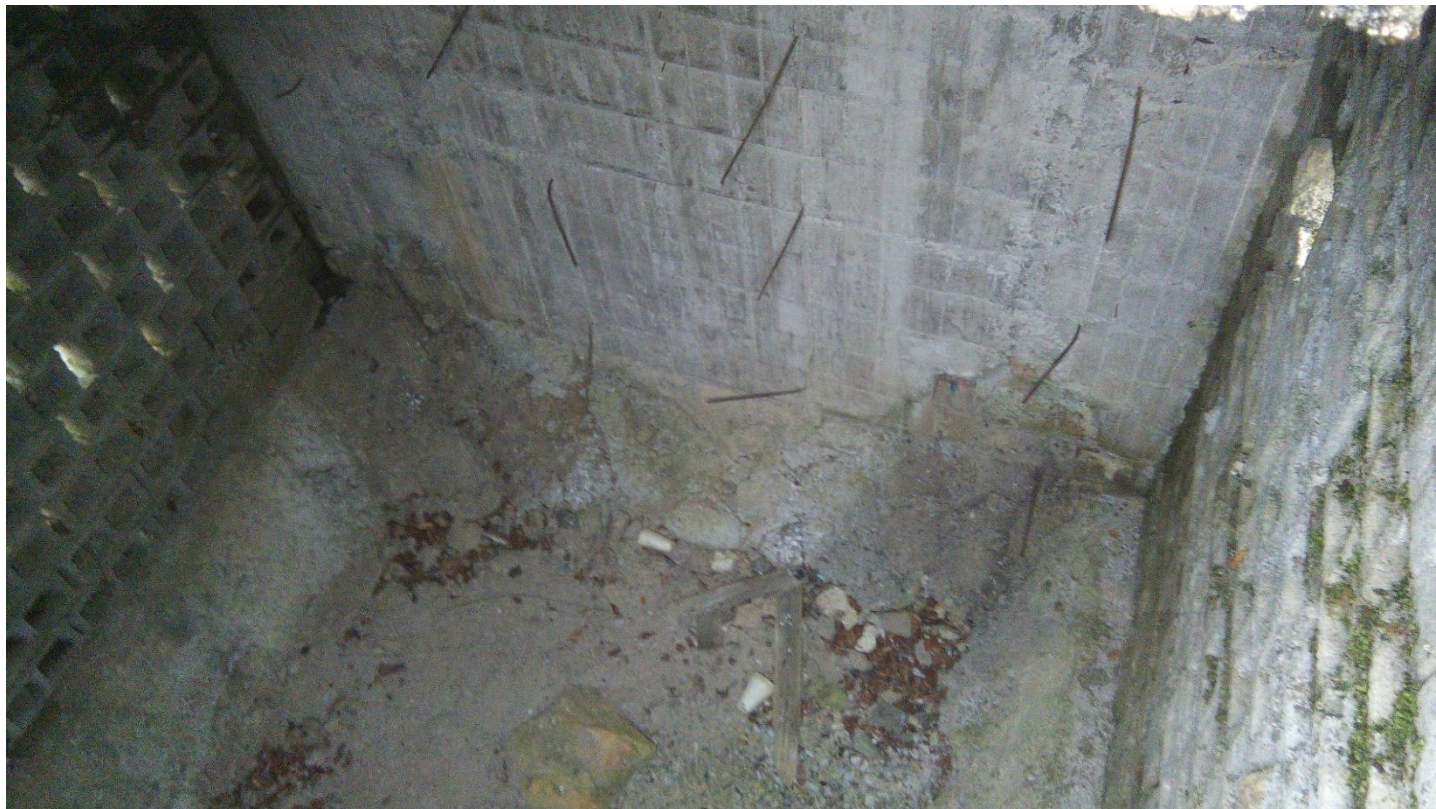
Φωτογραφία 4: Εσωτερικό της της απομονωμένης και εκτός λειτουργίας απορροφητικής δεξαμενής του συστήματος της Βάσης του X/K
