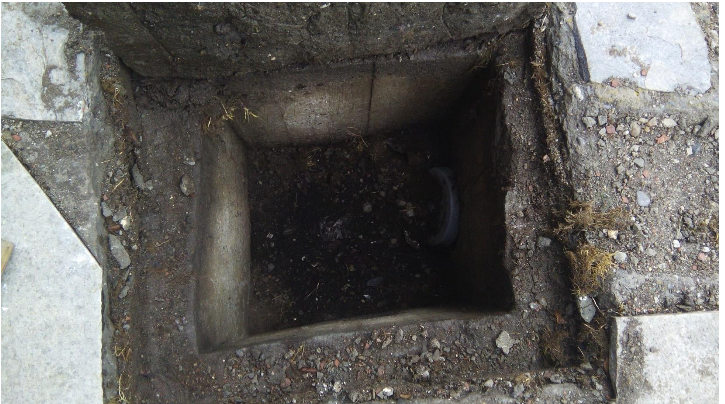
Φωτογραφία 6: Εσωτερικό της στεγανής δεξαμενής του συστήματος του Σαλέ της κορυφής στη θέση “Βουλγάρα”
