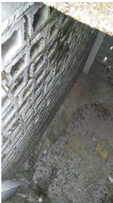
Φωτογραφία 3: Εσωτερικό της της απομονωμένης και εκτός λειτουργίας απορροφητικής δεξαμενής του συστήματος της Βάσης του X/K
